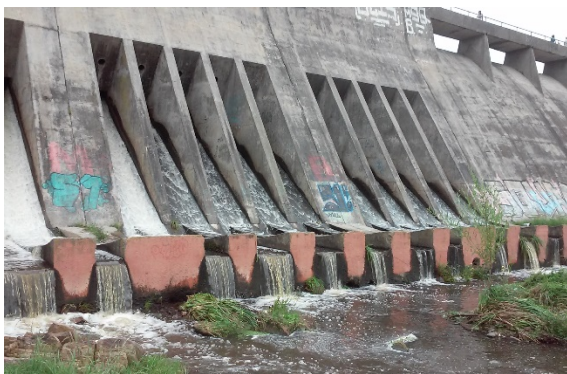
Figura 3. Sitio de medición del caudal en los vertederos a la salida del Embalse.
